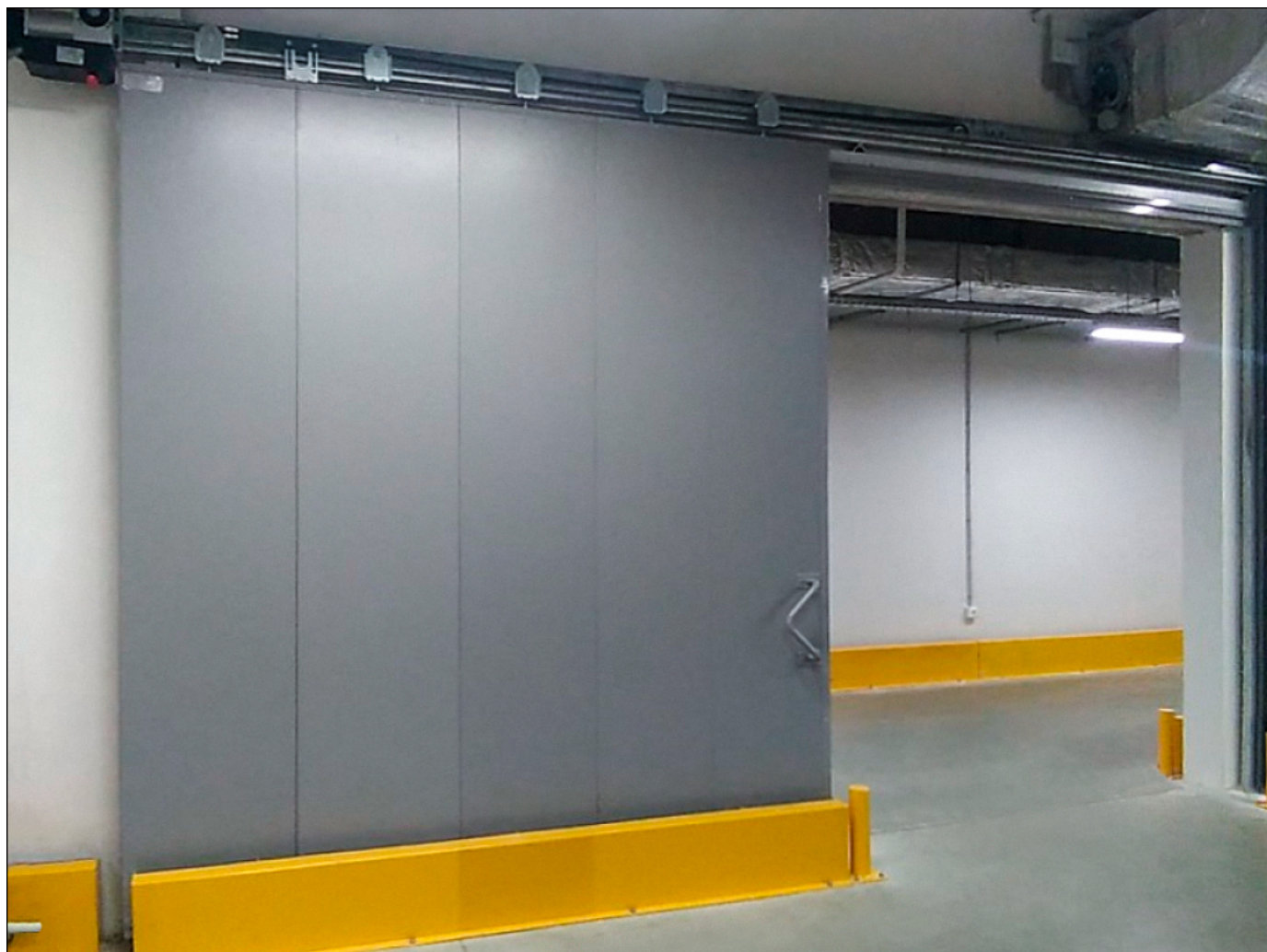
Откатные противопожарные ворота, установленные в складском комплексе
