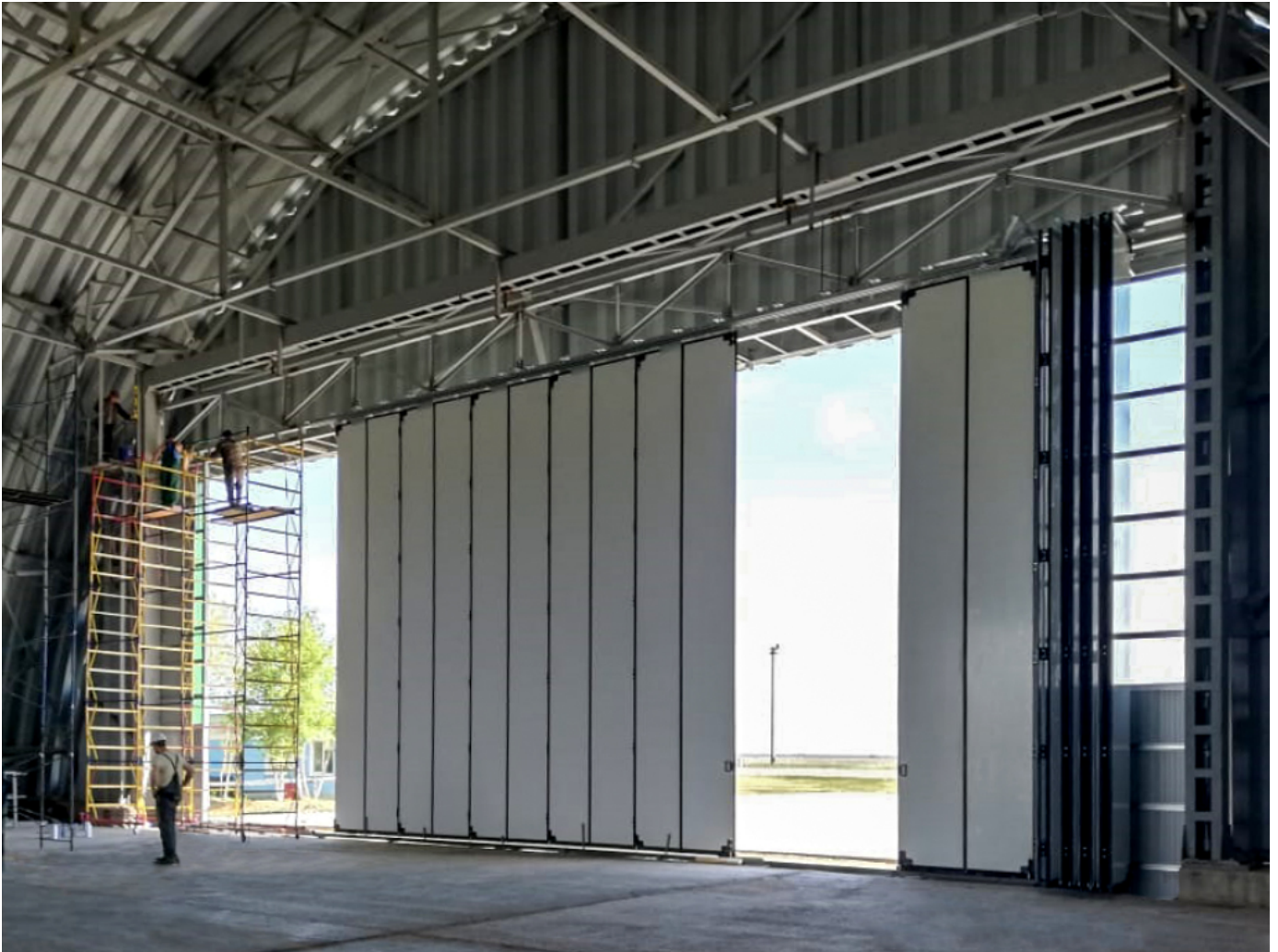
Промышленные складные ворота с нижней направляющей в процессе монтажа, вид изнутри ангара
