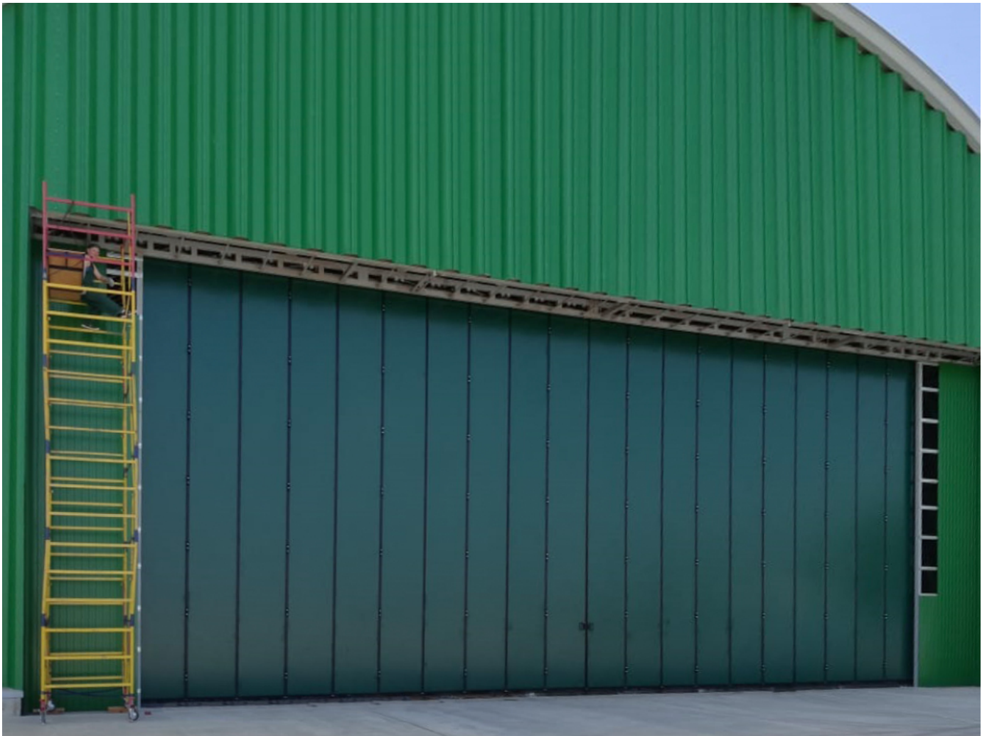
Промышленные складные ворота с нижней направляющей в процессе монтажа, вид снаружи ангара
