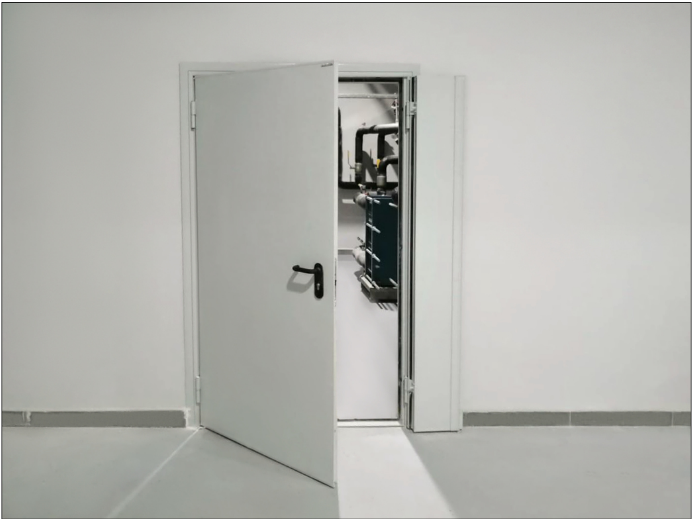
Противопожарная дверь двухстворчатая, установленная в логистическом центре. Нур-Султан
